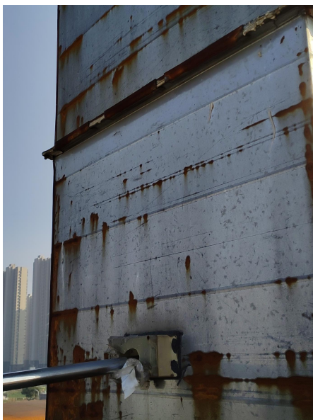
DA005 排气筒出口
